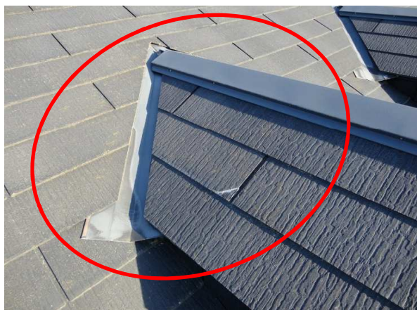
③棟トタン部チョーキングの発生
