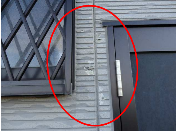
①板間目地シーリングの劣化
