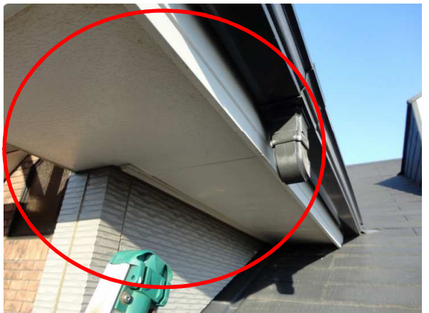
④軒天・破風チョーキングの発生
