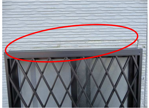
②外壁汚れ及び藻の発生
