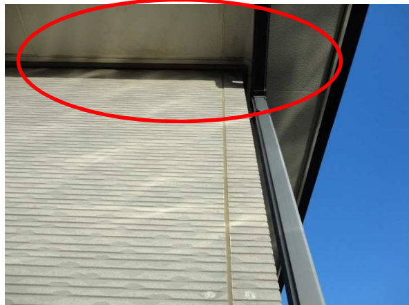
③軒天汚れ、埃の発生
