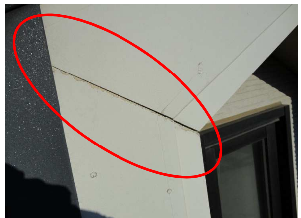
⑥破風ジョイント部隙間の発生
