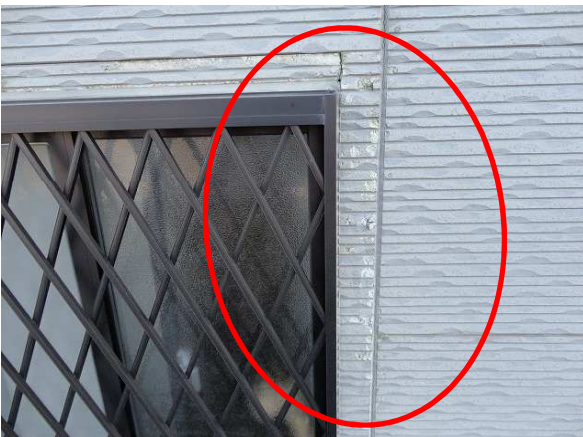
③板間目地シーリングの劣化
