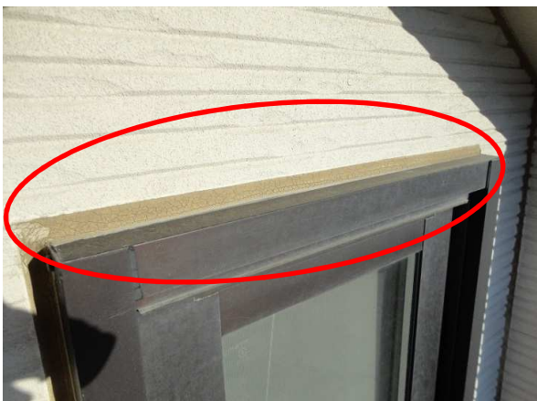
⑤開口部シーリングの劣化
