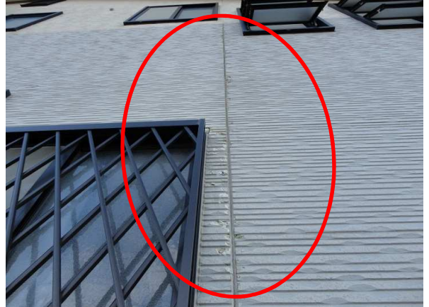
②板間目地シーリングの劣化
