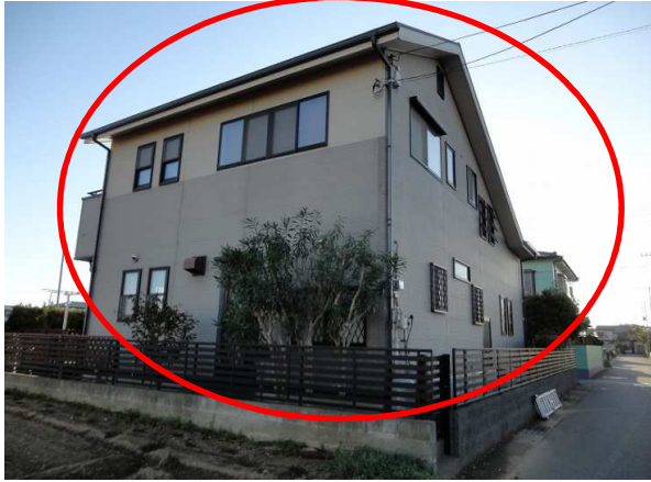
①汚れ及び塗膜チョーキングの発生
